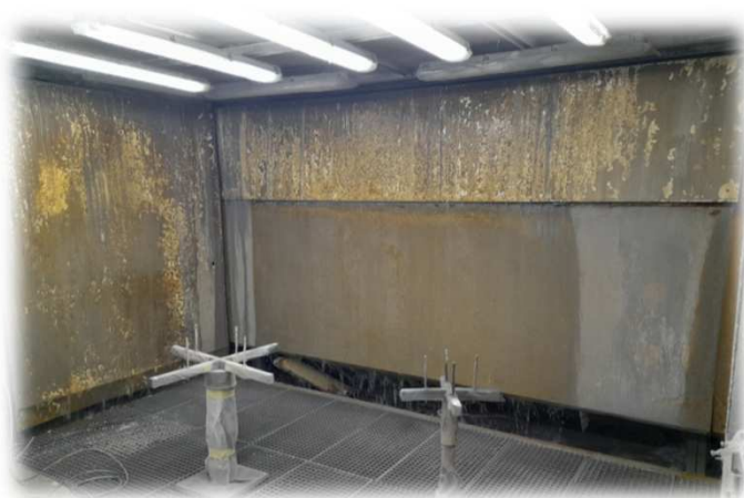
« Murs d'eau » dans une cabine de laquage
